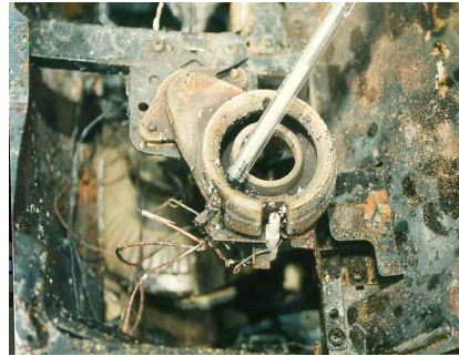
[ 그림 1-27 ] 소화안전장치 설치 “예”
