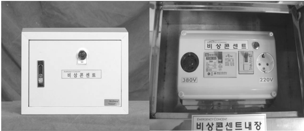
[그림 3-17] 비상콘센트설비함 및 소화전함 내장형
